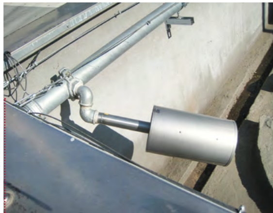
Cannone a schiuma a media espansione
