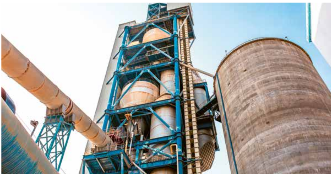
Foto: Enfriamiento y depuración de los gases de escape en el precalentador de suspensión.
